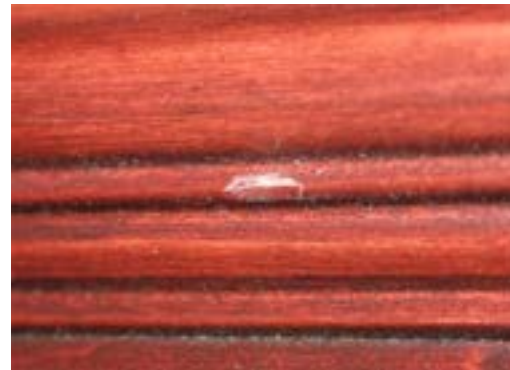
Vérifier les marques d'outils.
