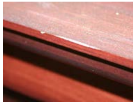
Vérifier les manques dans le fini.
